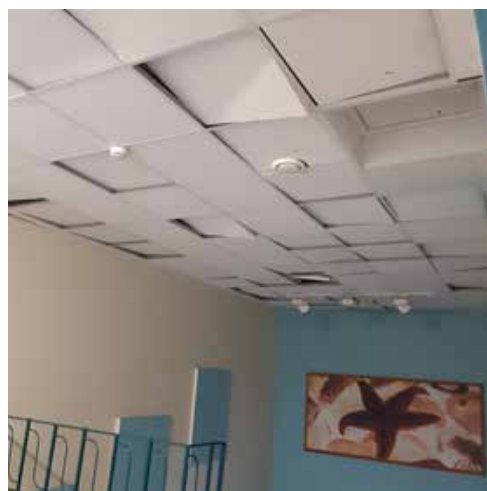
Skadegörelse i taket vid trapphuset i den undanskymda delen av skolan.
