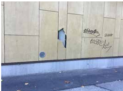
Skada i fasaden samt klotter.
