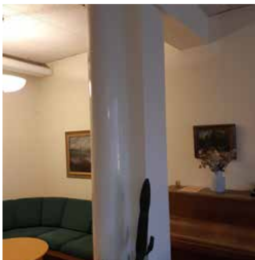
Pelare i personalrummet med tillbyggd ventilationsstrumma.
